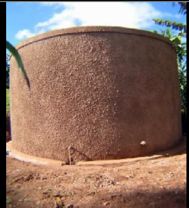
ε6. Δεξαμενή νερού
